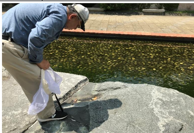
造景凹槽處積水
