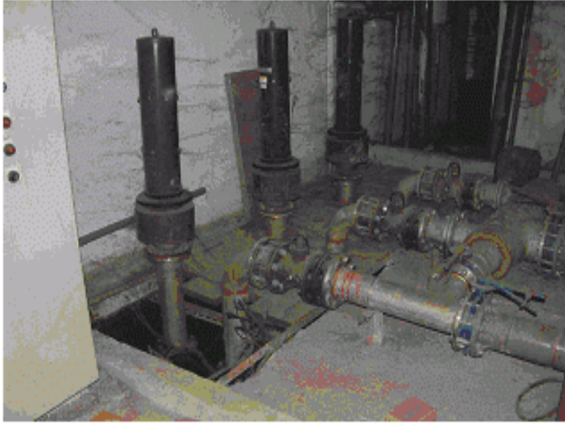
常見之高層連（多）棟之集合住宅之建築物污水處理設施（鼓風機及下方之曝氣槽）
